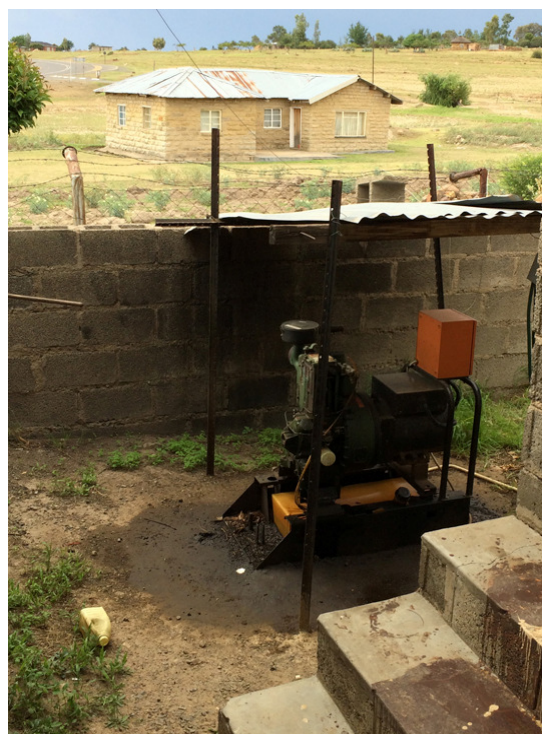
Dieselgeneratoren til rugemaskinen kører 24-7
